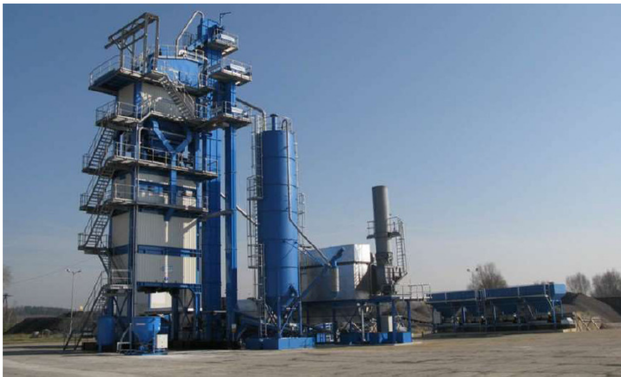
Joonis 1. Lubatud heitkoguste projektis esitatud asfaltbetoonisegisti visualiseering (OÜ GeoKes, 2019)
