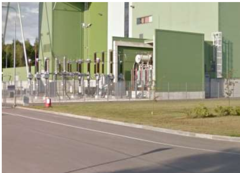
Foto 2. Illustratiivne näide alajaamast.
