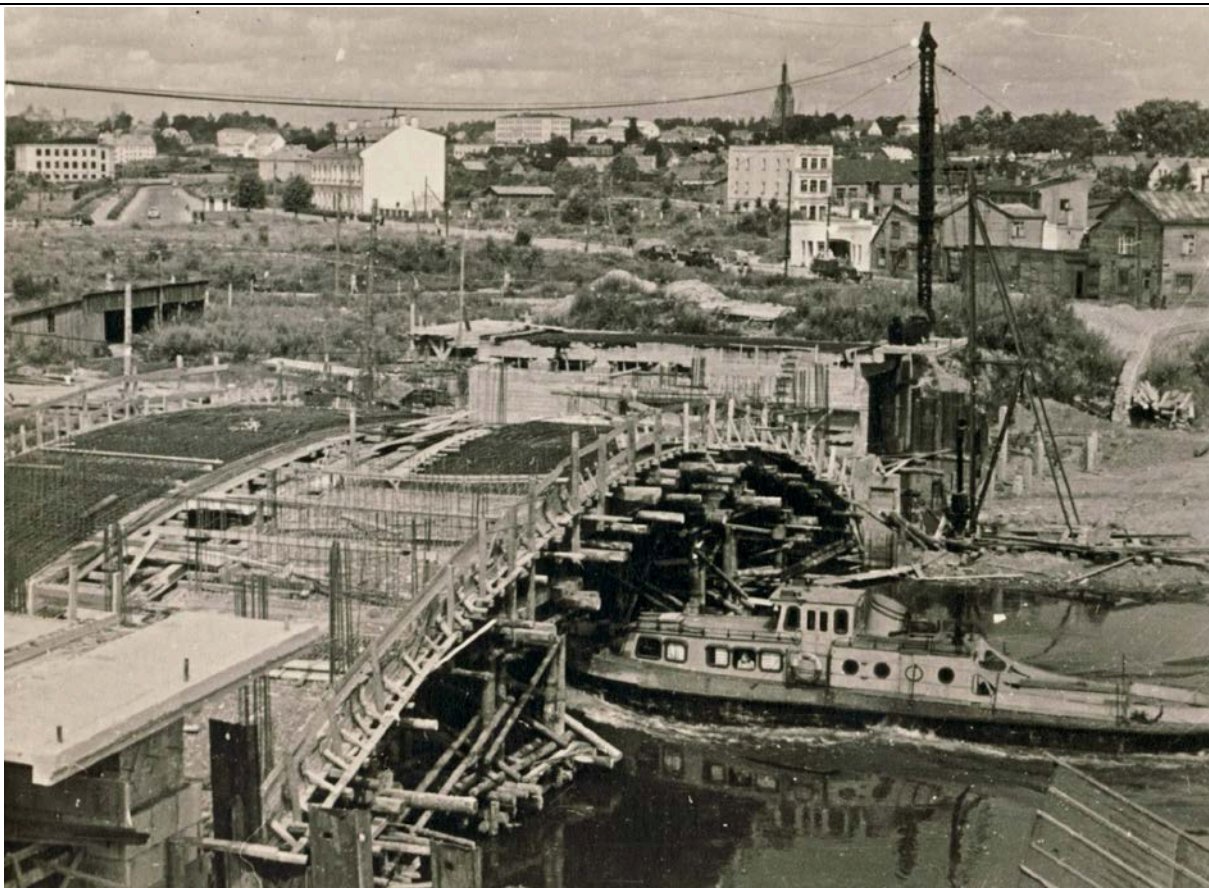
Pilt 155. Tänapäevase Rahu silla ehitus 1955.-56. a fotol. Planeeringuala jääb silla taha. Kaugemal paistab Narva mnt 23 säilinud hoone, tänapäevane Tartu linnamuseum.
