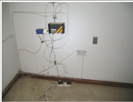
Ruumides on elektrivarustus
