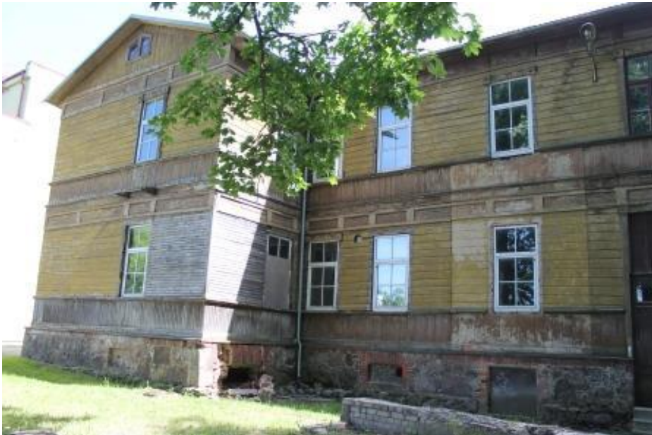
Foto 3. Vaade hoone idatiiva loodeseinale. Enamus idatiiva algsed aknad on vahetatud plastikraamide vastu. Algsed puidust piirdeliistud on eemaldatud. Nii loodeseinas kui ka kaguseinas on osa seina puitlaudise asemel kaetud krohviga, mis imiteerib ümbritsevat laudist ja fassaadi detaile.
