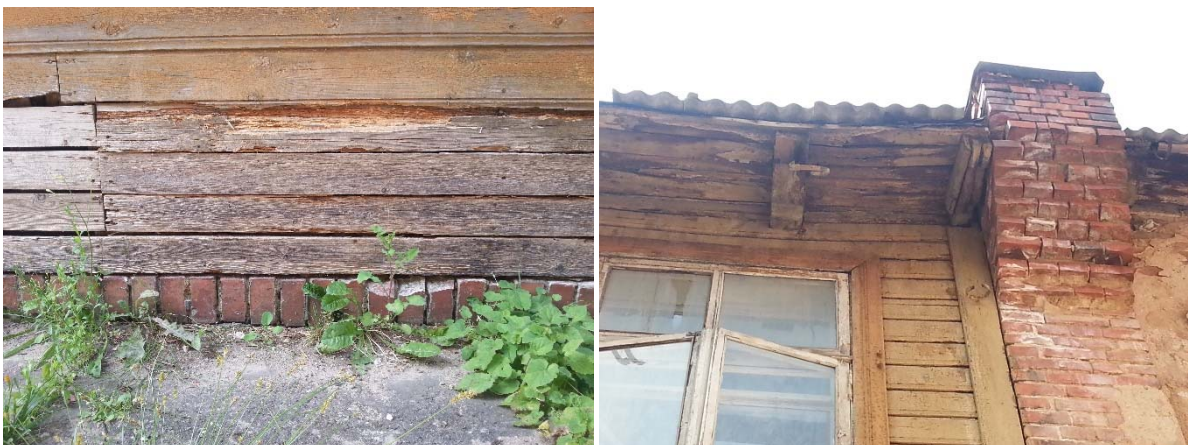
Joonis 7. Tiigi tn 80 kahjustatud vundamendipealne ja räästaalune.
