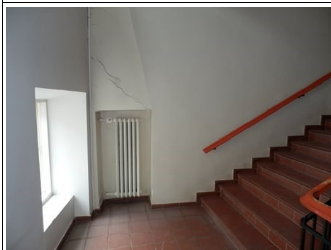
Pääs teisele korrusele. Ka hoone Gildi ja Rütli tänavate nurk on kergelt vajunud.
