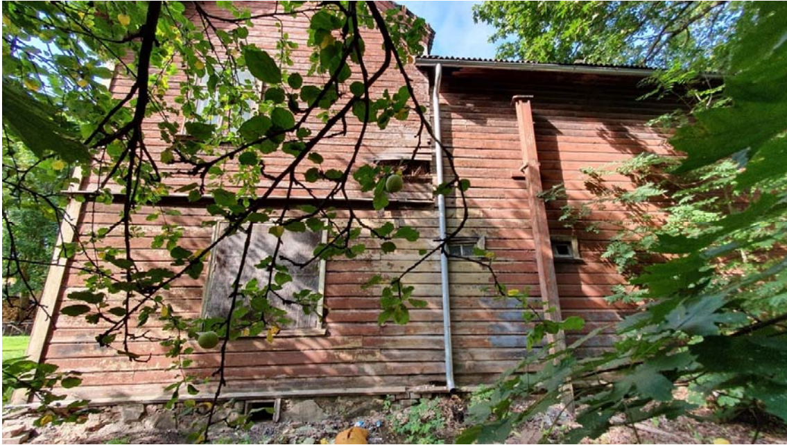
Pilt 28. Näituse tn 6 elamu tagakülg, vaade kirdest, Näituse tn 2a krundi poolt. Hoone on kasutuseta, kuid tänu katusele, remonditud rennidele ja vihmaveetorudele on pöördumatu ehituslik kahju ära hoitud. Autor: Mart Hiob 2019.
