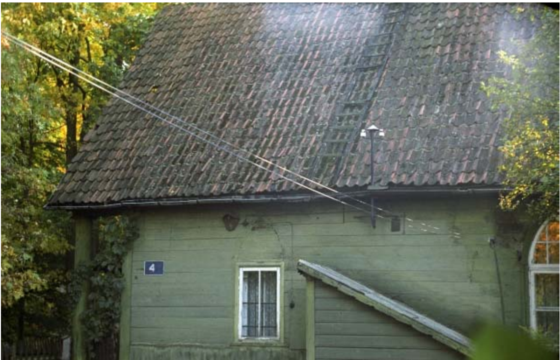
Pilt 2. Pargivahi maja enne lahtivõtmist 1999. a alguses, vaade põhjast. Allikas: Eesti rahva muuseum, ERM Fk 2616:5.
