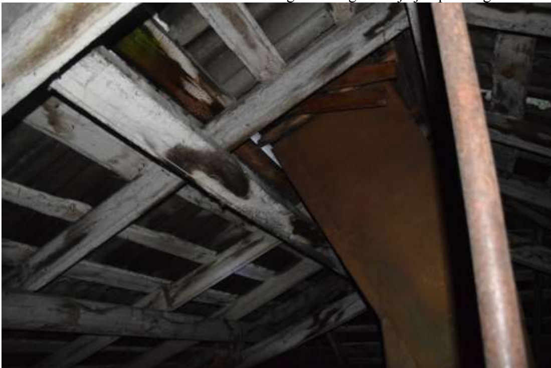
Foto 12. Sademevee lekke koht katusel ventilatsioonikorstna piirkonnas
