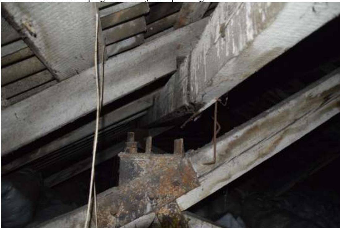
Foto 14. Katusesõrestiku ebaõige tugevdamine, mille tulemusena on purunemise oht
