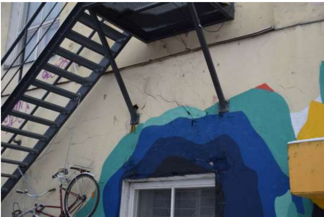
Foto 3. Pragu otsaseina avariiväljapääsu all
