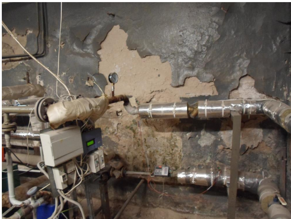
Foto 3: Keldris asuva soojasõlme seinad on väga tugevate niiskuskahjustustega
